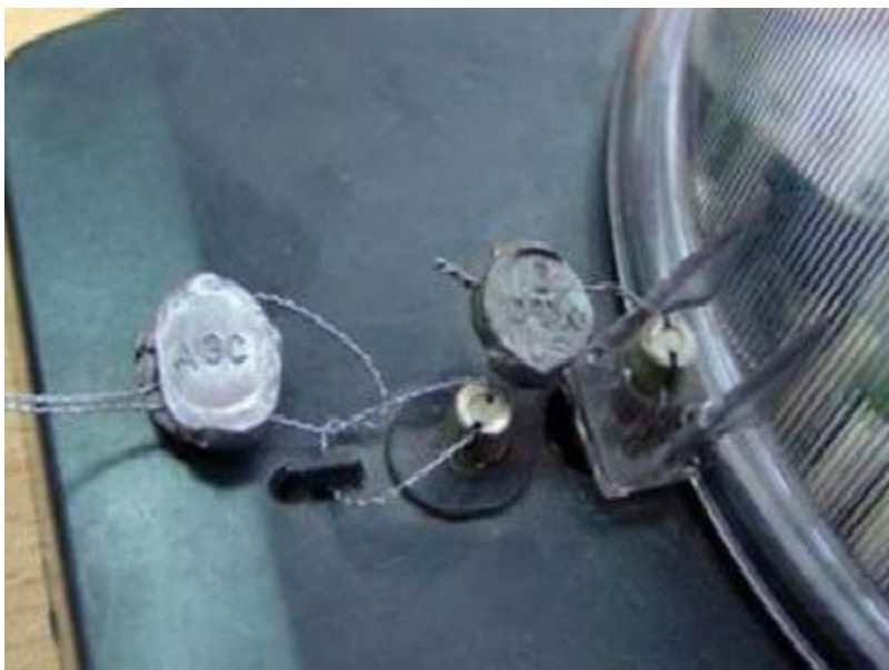
Пломба на устаревшем индукционном электросчетчике является единственной защитой от несанкционированного доступа внутрь корпуса
